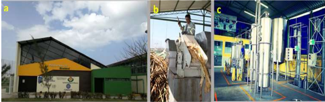
Figura 7. Planta piloto de Bioetanol del Instituto Tecnológico de Veracruz. (a) fachada principal, (b) molienda de caña de azúcar, (c) sistema de evaporación y destilación.
