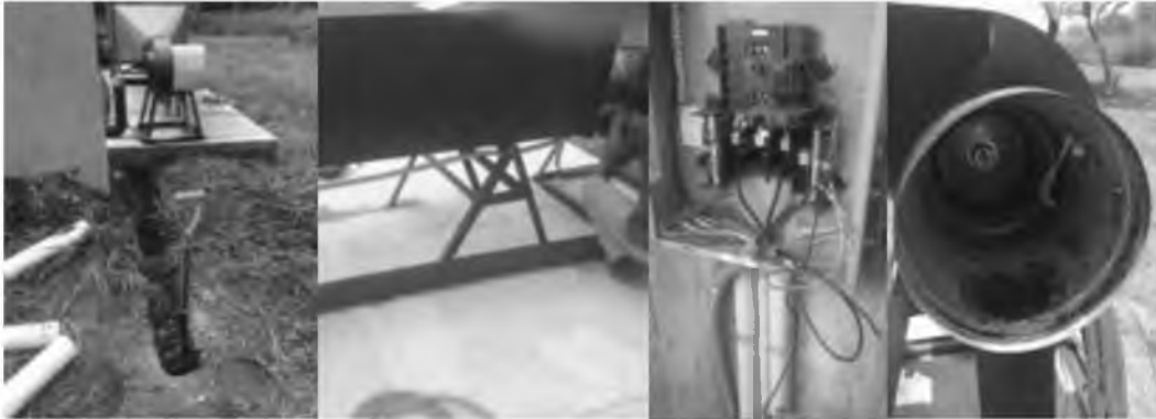
Fig. 3.16 Cableado del secador
