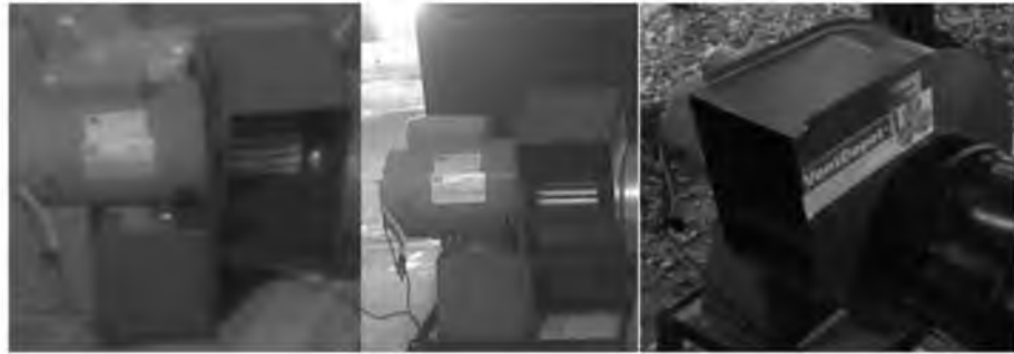
Fig. 3.9 Motor monofásico de arranque por capacitor (Extractor de aire).
