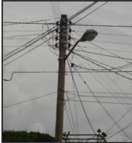
Figura 9. Alumbrado público encontrado en vialidades vecinas
