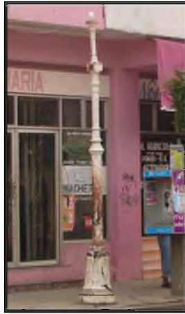
Figura 39. Luminarias en mal estado
