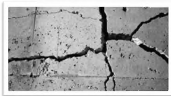
Fig. 2. Fisuración del concreto.
