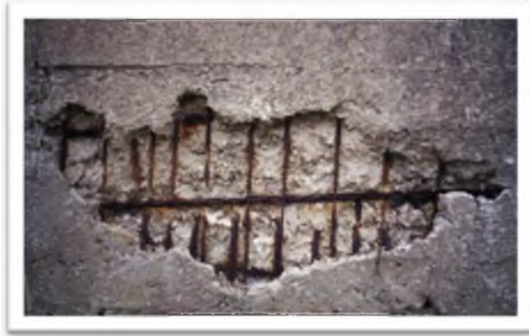
Fig. 1. Corrosión del acero de refuerzo.
