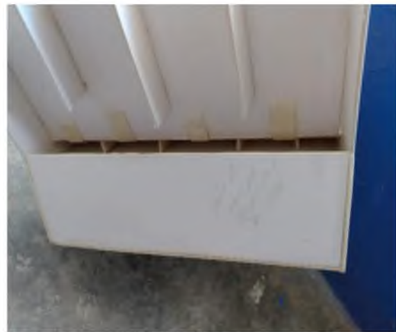
Figura 41. Banca pegada con pegamento blanco y con refuerzos.
