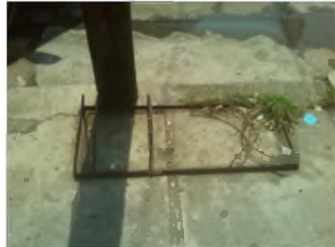
Figura 16: Aparcabicicletas en mal estado.
